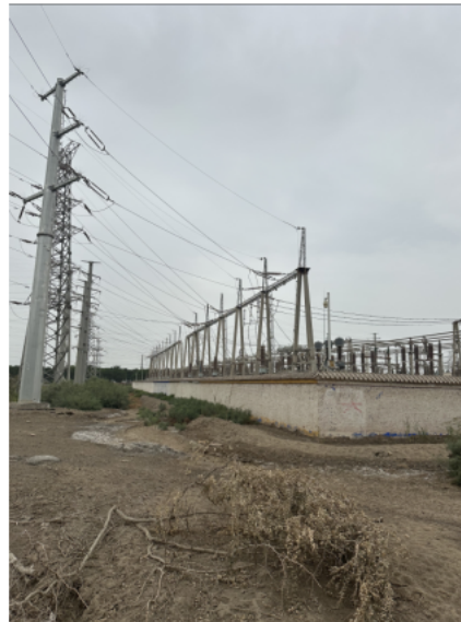
线路终点园区变电站
