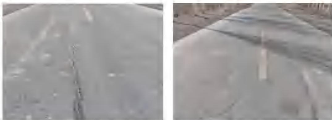
既有道路路面情况 (K13+420~K14+380) (网裂、纵裂)
