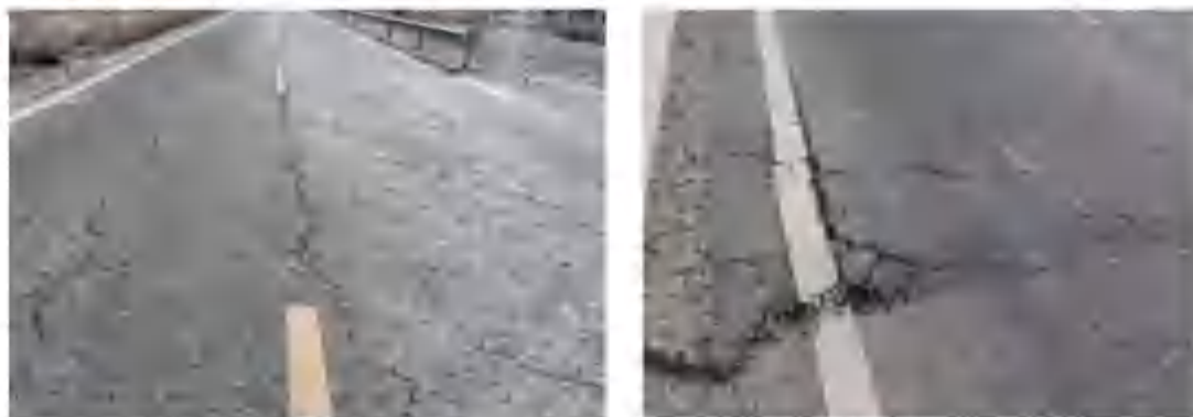
既有道路路面情况 (K18+560~K24+060) (网裂、纵裂、冻胀)
