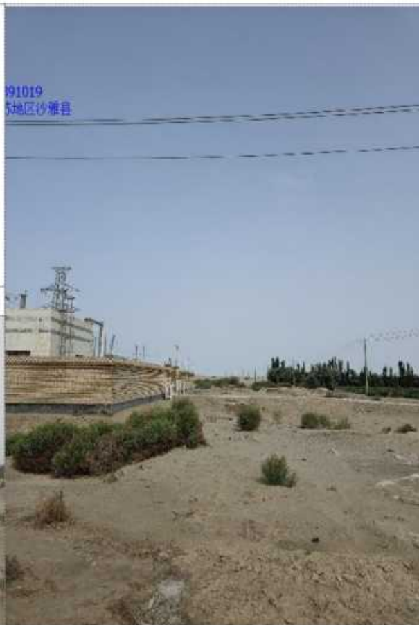
英也 35kv 升压站出线侧
