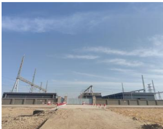
军垦(阿拉尔工业园)220kV 变电站
